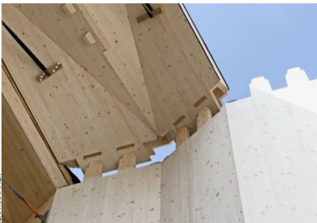
Pour la première fois, la technique ancestrale d'assemblage bois-bois grâce à des tenons a été appliquée à l'échelle d'un bâtiment.
